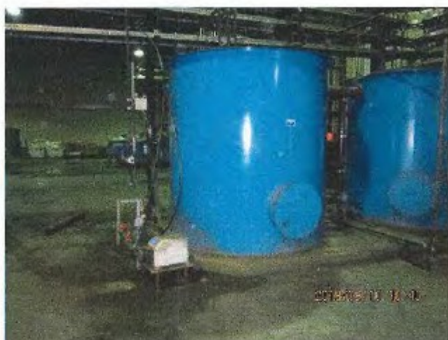
(photo 9) IMG_0268.JPG deux réservoirs d'eau de procédé de 10m3
