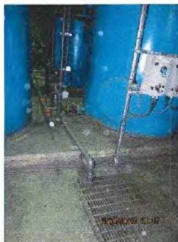
(photo 10) IMG_0269.JPG deux réservoirs d'eau de procédé de 10m3
