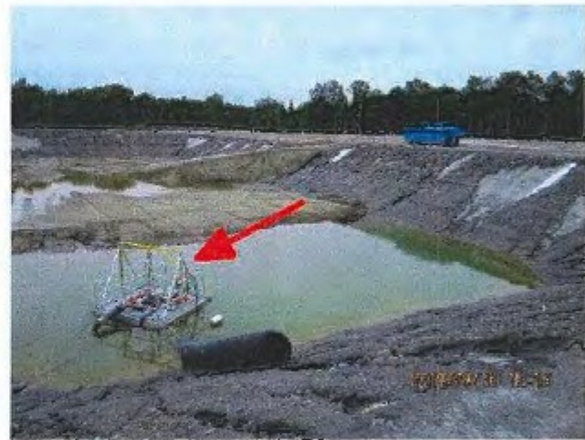
(photo 22) IMG_0302.JPG pompe installée dans le parc à résidus
