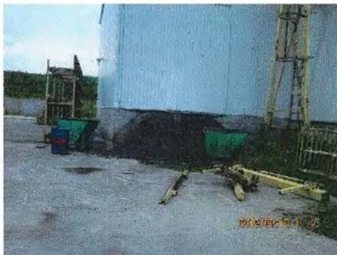
(photo 4) IMG_0285.JPG arrière du bâtiment brisé
