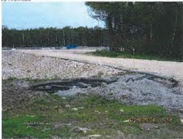
(photo 31) IMG_0329.JPG tuyau utilisé pour dénoyer la fosse d'extraction
