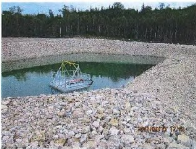
(photo 23) IMG_0311.JPG bassin de sédimentation
