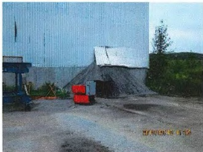
(photo 3) IMG_0284.JPG arrière du bâtiment brisé
